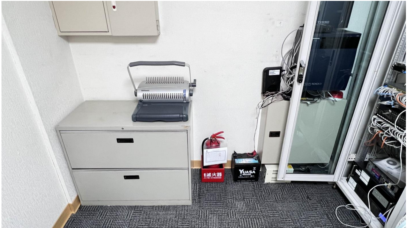
圖 6-1 保管櫃及防災設備
