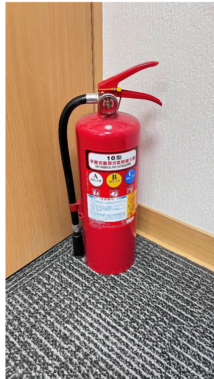
圖 6-2 機房內防災設備
